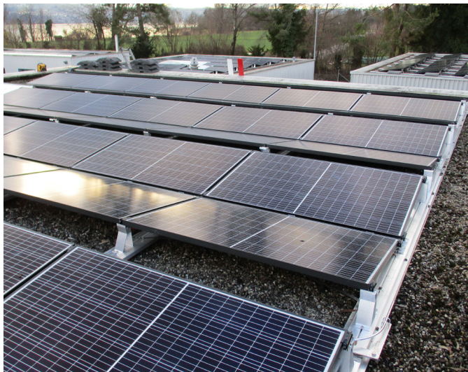
PV-Anlage auf Dächern der ARA Hombrechtikon
