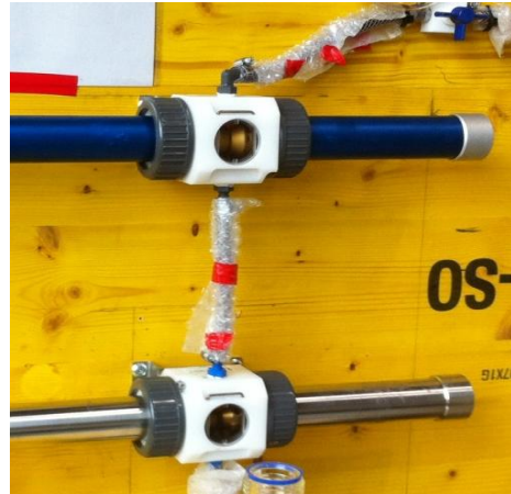
Eigenes Foto UV-Sonde Versuchshalle Eawag
