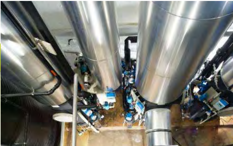
Erste volltechnische Luftstrippanlage der Schweiz
