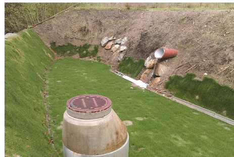
Retentionsbecken Pözlleitner Ablenau - Geinger Baumanagement GmbH
