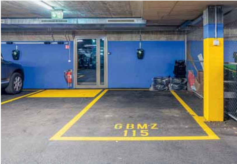
Zwei der insgesamt sechs Parkplätze, bei denen die Ladestation bereits installiert wurde. Weitere 18 Parkplätze sind mit einer Zuleitung versehen worden, sodass nur noch die Ladestation angebracht werden muss, wenn ein Bedarf gemeldet wird. Quelle: Savenergy Consulting / Georg Holubec
