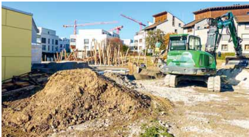
Die Gemeinde Jonschwil-Schwarzenbach nutzte den Bau des neuen Primarschulhauses, um das ganze Areal naturnah aufzuwerten.
