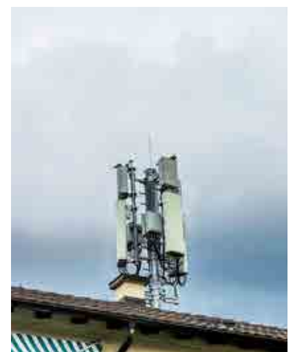
Mobilfunkanlage mit zwei Antennenebenen: Unten konventionelle Multibandantennen, oben adaptive Antennen, die mit einem Korrekturfaktor betrieben werden können.
