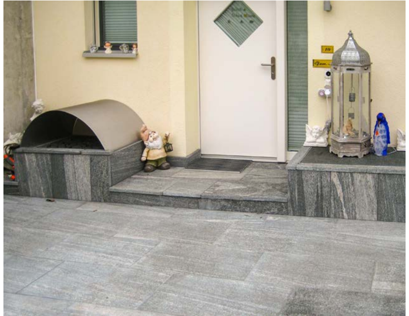
Objektschutzmassnahmen schützen Gebäude vor Hochwasser – beispielsweise indem Lichtschächte erhöht gebaut werden. Solche Massnahmen werden neu in den meisten Fällen von den Gemeinden und nicht mehr vom Kanton angeordnet. Quelle: AWEL
