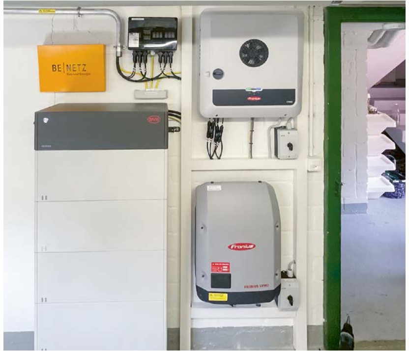
Stromspeicher, Energiemanagementsystem und Wechselrichter werden für die PV-Speicher-Kombination in einem Einfamilienhaus einzeln installiert und im besten Fall über ein intelligentes Energiemanagementsystem (EMS) verbunden. Quelle: BE Netz AG
