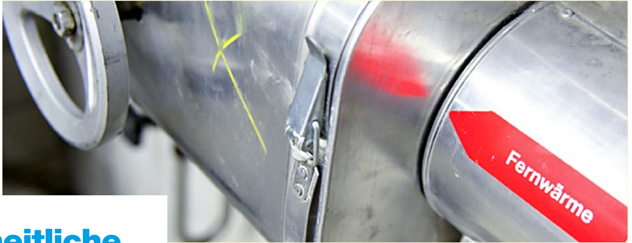
Fernwärmeverbundgebiete sollen besonders gefördert werden. Im Bild: Fernwärmeleitung. Quelle: Limeco
