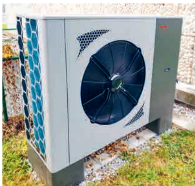
Aussen aufgestellte Luft-Wasser-Wärmepumpe im Kanton Zürich.
