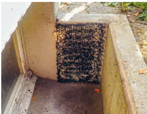
Krallmatten als Ausstiegshilfen für viele Kleintiere sind kostengünstig und lassen sich auch in privaten Liegenschaften einfach montieren. Quelle: Thomas Gerber
