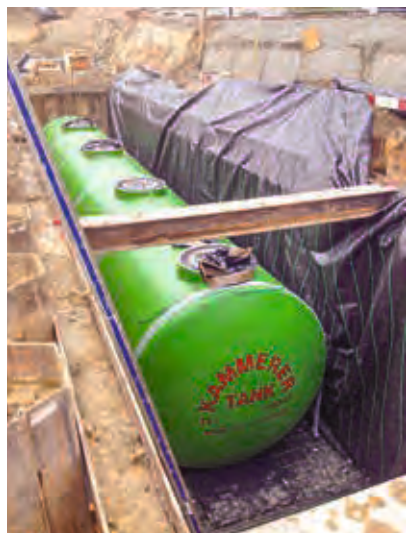
Um Gewässerverschmutzungen zu vermeiden, müssen Tankanlagen regelmässig kontrolliert werden. Quelle: AWEL
