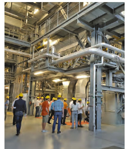
Viel Energie aus den Prozessen in der KVA Hagenholz kann genutzt werden. Quelle: ©ETH Alumni Vereinigung
