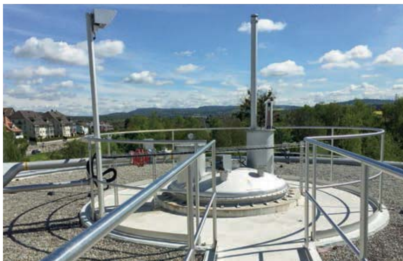
Offener (oben) und geschlossener (unten) Stapelbehälter für Faulschlamm.
