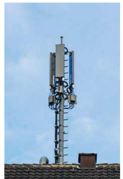
Ohne Antenne kein Empfang: Mobilfunk-Basisstation in der Stadt Zürich.
