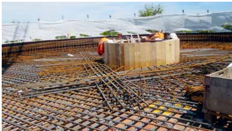
Der Schlammstapel der ARA Fischbach-Glatt in Niederglatt wurde im Frühling 2015 mit einem Betondeckel ausgerüstet. Über eine Gashaube auf dem Betondeckel wird das methanhaltige Gas dem Speicher zugeführt. Damit kann das zusätzlich produzierte Gas energetisch genutzt werden. Quelle: ARA Fischbach-Glatt
