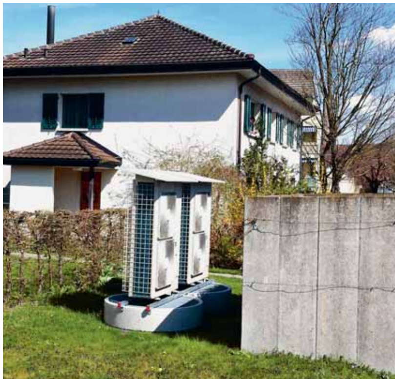
Aussen aufgestellte Luft/Wasser-Wärmepumpe in einem Wohngebiet. Die Gefahr von Lärmbelastigungen ist erhöht. Es ist eine besonders gute Planung erforderlich. Quelle: TBA/Fachstelle Lärmschutz
