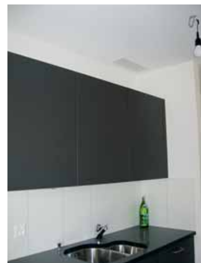
Die Abluft in der Küche wird durch das Gitter an der Decke abgesaugt. Quelle: Zehnder Schweiz AG
