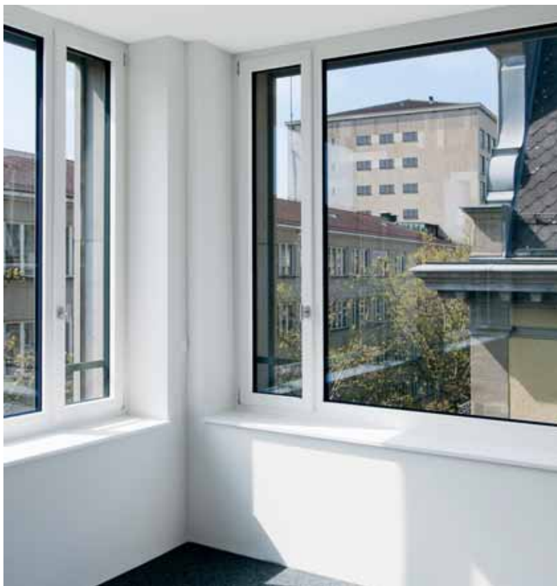
Optimal ist die Kombination von mechanischer Lüftung mit Fenstern, die man öffnen kann. Quelle: HBA
