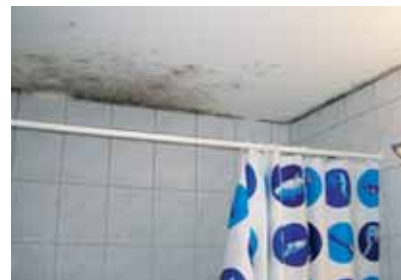
In solchen feuchten, kühlen Ecken bildet sich schnell Schimmelbewuchs. Quelle: Belfor (Suisse) AG
