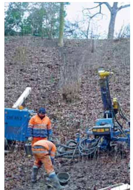
Abtiefen einer Bohrung am Fuss der Deponie Rossbächli mit anschliessendem Ausbau als Sickerwassermessstelle.
