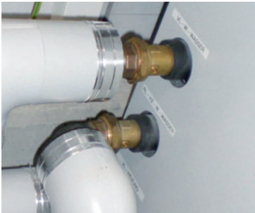
Mit dem Einsatz von flexiblen Anschlüssen (Gummielemente) kann Körperschall vermieden werden.
