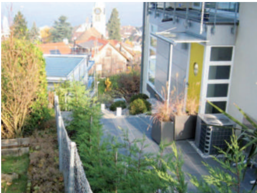
Durch den Lärm einer Wärmepumpe (rechts im Bild) kann eine schöne Wohnlage in ihrer Qualität gemindert werden.
