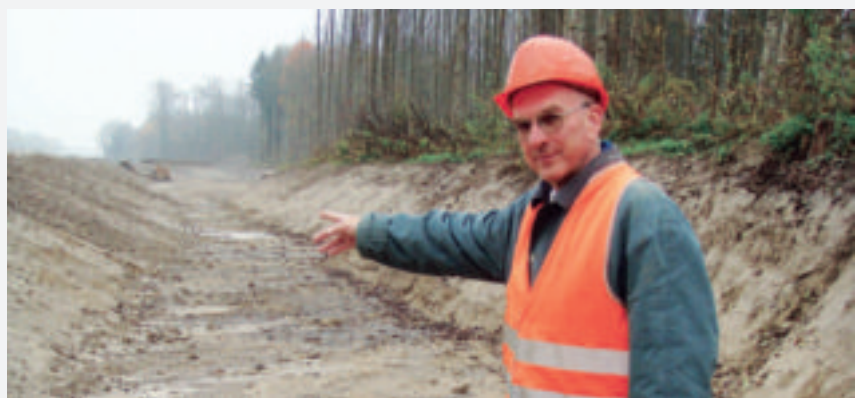
«Eine BBB lohnt sich auch für den Bauherrn. Eine Totalsanierung kommt viel teurer», sagt Werner Rohr.
