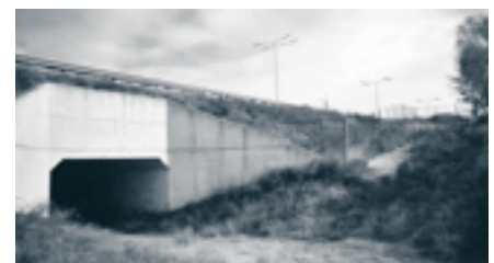
Unterführung für Wildtiere an einer Autobahn (Beispiel aus den Niederlanden). Zäune leiten die Tiere zur Unterführung hin.
