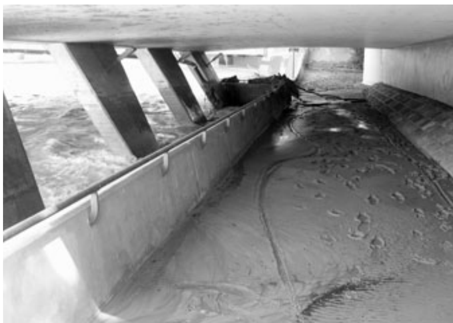
Eine Unterführung bei der Allmend Brunau an der Sihl nach dem Hochwasser im August 2005: Noch steht das Wasser viel höher als üblich. Gut sichtbar ist der abgelagerte Sand sowie Treibholz.
