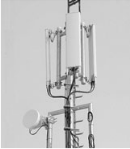
Dank der NIS-Verordnung konnte der rasche Ausbau des Mobilfunknetzes ohne übermässige Strahlungsbelastung bewältigt werden.
