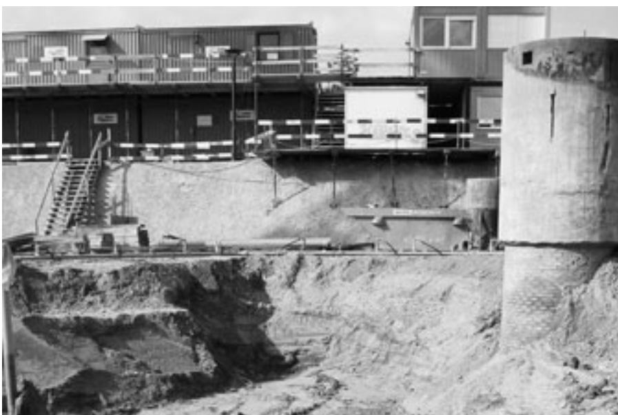
Leerstehende Liegenschaften und Industriebrachen sollen genutzt – sozusagen recycelt – werden, um Grünflächen unbebaut zu erhalten. Flächenrecycling und Schonung der Ressourcen sind Ziele der Abfallpolitik des Kantons Zürich. Bauen auf belasteten Standorten wird nicht behindert, sondern gefördert.
