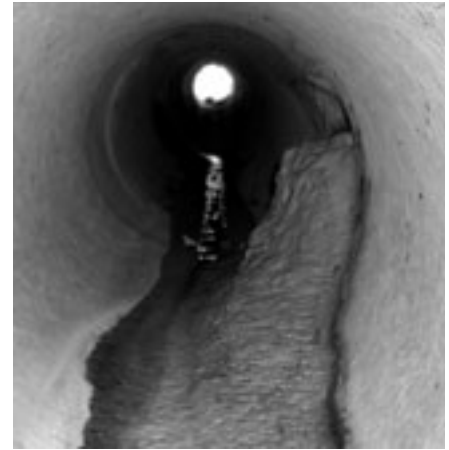
Ablagerungen im Kanalisationssystem werden teuer.
