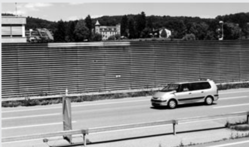
Lärmschutz der Pionierjahre – der Kanton Zürich nahm den Autobahnlärm von Beginn weg ernst. Unterdessen stehen Renovationen und Erweiterungen ins Haus (Bild: Limmattal, schadhafte Eternit-Lärmschutzwände).
