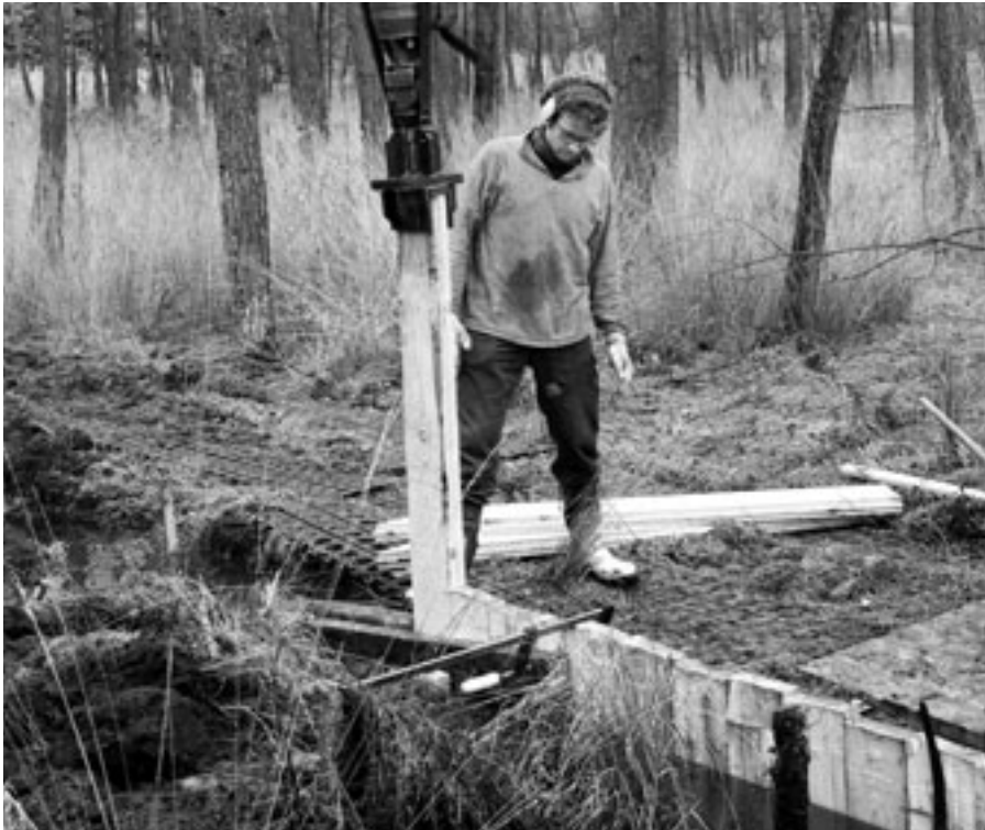
Zur Abdichtung eines Grabens im «Wildert» bei Illnau-Effretikon wird eine Holzspundwand in den Boden gerammt.
