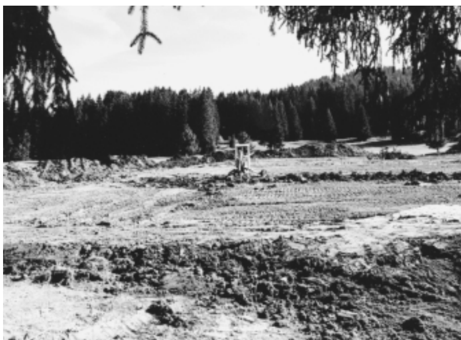
Die Auswirkung der Bauarbeiten auf den Naturhaushalt dürfen nicht unterschätzt werden. Durch die Terrainarbeiten können irreversible Bodenverdichtungen entstehen. Quelle: BUWAL
