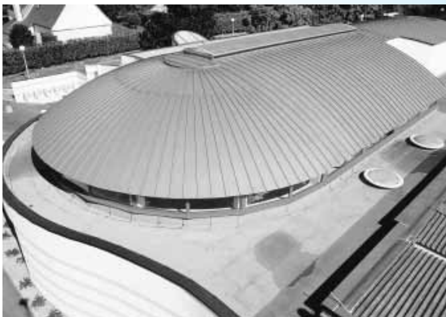
Abschwemmungen von Metalldächern können Boden und Wasser beeinträchtigen. Im Bild: Piscine Guyancourt.
