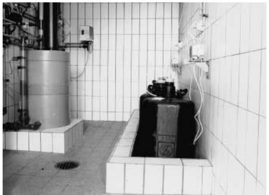
Chlordioxidanlage zur Wasseraufbereitung
