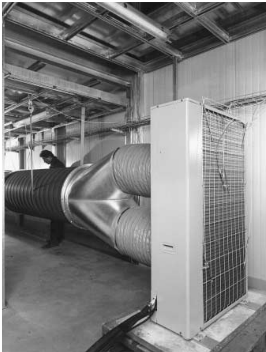
Luft-Wasser-Wärmepumpe bereit zum Test in der Klimakammer des WPZ Töss
