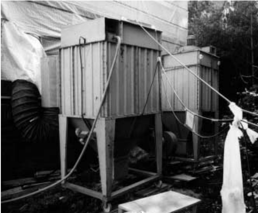
... der Thurbrücke der SBB bei Ossingen sowie Detailaufnahme der Abluft-Filteranlage beim gleichen Objekt
