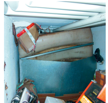
Schadenfall Kleintank nach einem Hochwasser (AWEL, 2014)
