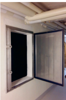
Bild oben: dichte Tankraumschutztür
