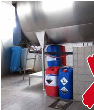
Gefährliche Stoffe nicht neben Bodenabläufen lagern.
