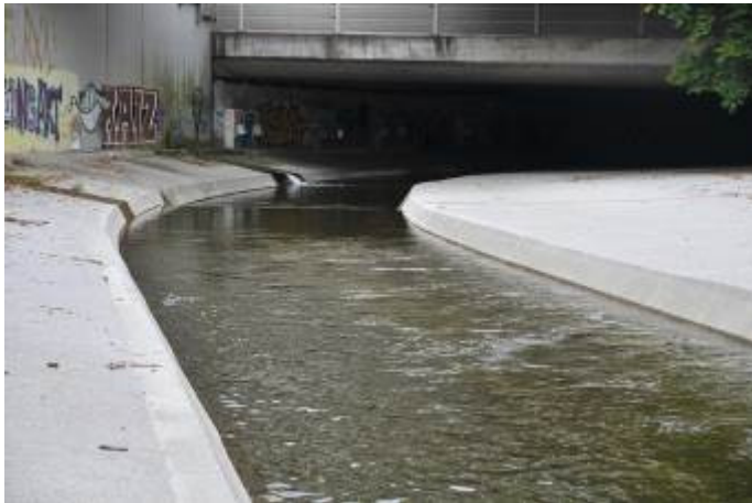
Foto 1. Die Töss bei Winterthur vor der Autobahnanterquerung bei der Rieter AG. Bei Normalwasserführung kann ein Biber auf einer Strecke von 450 Meter Länge nicht aus dem Wasser auf die Betonsohle klettern.
