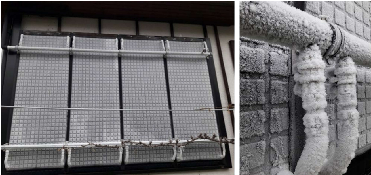
Abbildung 5: Solarabsorber an der Südfassade während einer Nebel-Kälte-Periode. Durch den Wärmeentzug bildet sich an der Oberfläche Kondensat, welches anschliessend gefriert.
