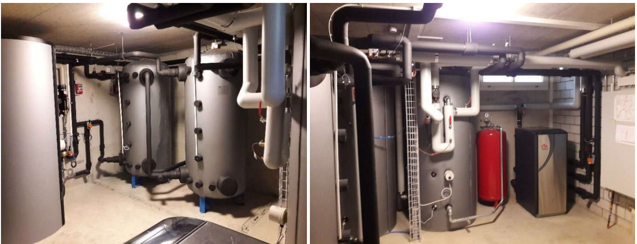
Abbildung 18 Linkes Bild: Der Brauchwarmwasser- (links) und die Verdampferspeicher. Dazwischen sind die Leitungen zu den Solaranlagen sichtbar. Rechtes Bild: Die Wärmepumpe, das Expansionsgefäß und die beiden Heizungsspeicher (der linke ist teilweise verdeckt). Am rechten Bildrand ist der Steuerungsschrank.
