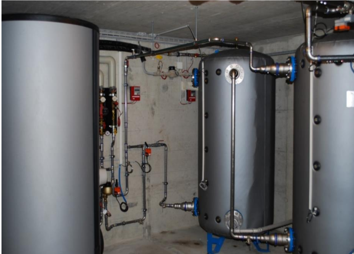
Abbildung 10 Der Brauchwarmwasserspeicher (links) und die beiden Verdampferspeicher. Dazwischen sind die Leitungen der Solaranlagen sichtbar. Zum Zeitpunkt der Aufnahme sind die Leitungen noch nicht isoliert.
