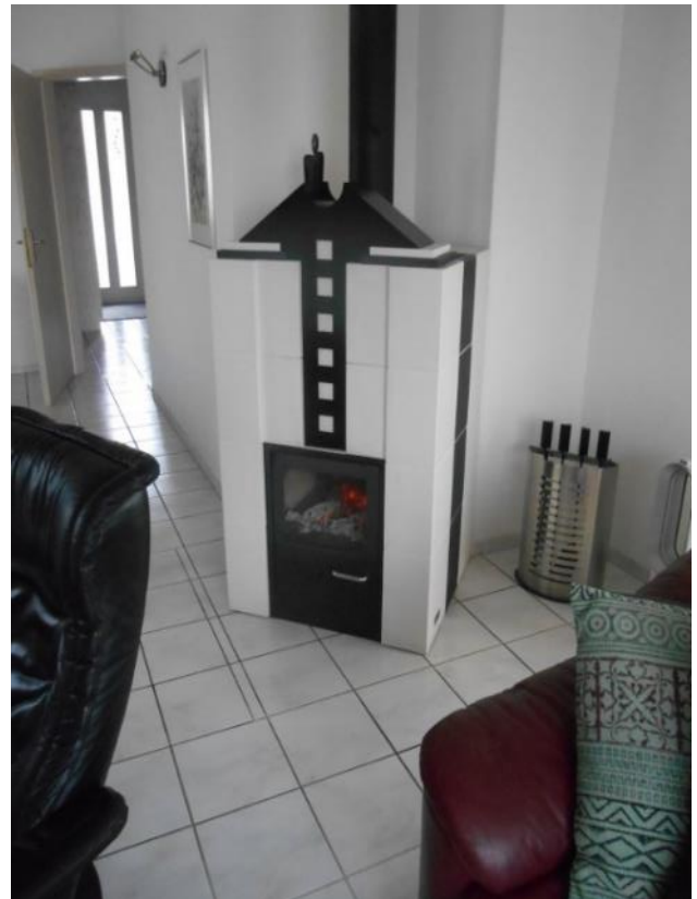
Abbildung 5 Mantel Futura Holzspeicherofen im Wohnzimmer mit einer Kapazität mindestens 30 kWh. pro Tag.
