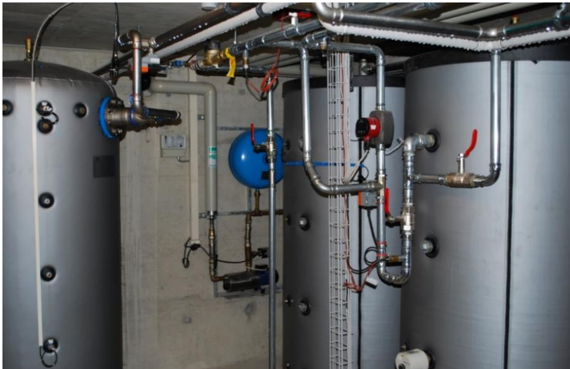
Abbildung 11 Einer der beiden Verdampferspeicher (links) und die beiden Heizungsspeicher. Im Hintergrund sind der Druckbehälter (blau) und darunter der Kompressor der Regenwasseranlage sichtbar. Zum Zeitpunkt der Aufnahme sind die Leitungen noch nicht isoliert.
