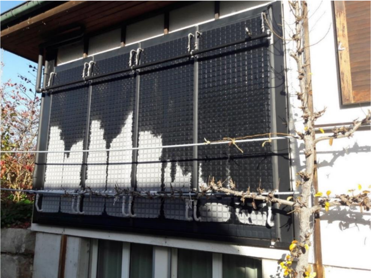
Abbildung 9 ESSA Solarabsorber von Energie Solaire SA an der Südfassade des Hauses beim Abtauen während Solareinstrahlung.
