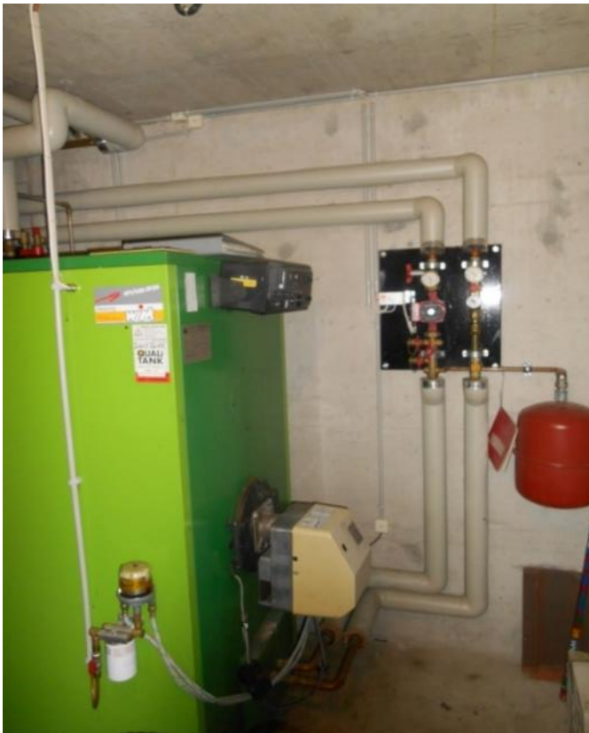
Abbildung 4 Der Schuster Ölkessel mit einer Leistung von 16 kW, einem Solarregister und einem Speichervolumen von 600 Litern mit integriertem Brauchwarmwasserboiler (200 l).
