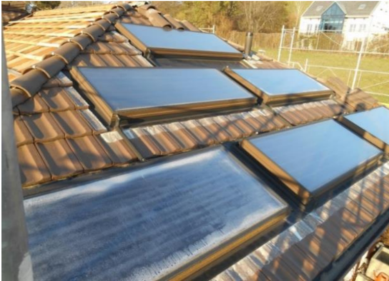
Abbildung 3 Verglaste Schweizer Sonnenkollektoren auf dem Süddach. 6 Module à 1.5 m 2 . Unten links ist das Kondenswasser gut sichtbar.
