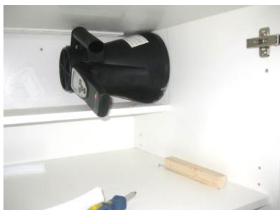
Abb. 26: Messung des Abluft-Volumenstroms in der Küche
