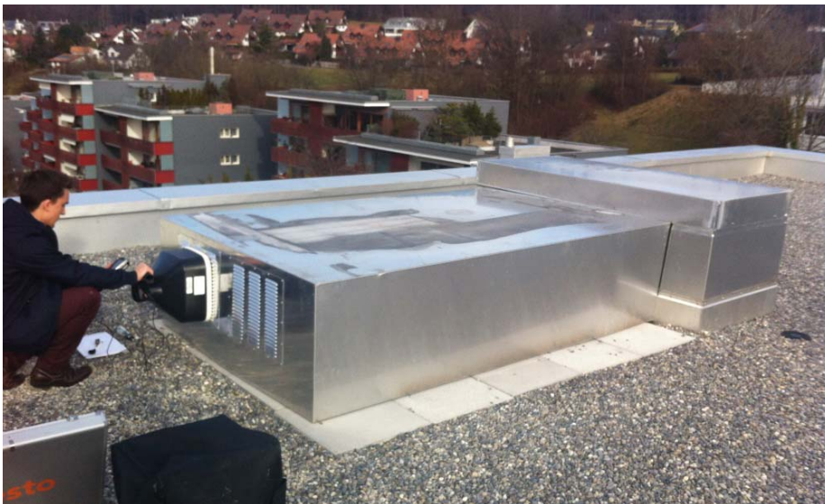
Abb. 5 : Eine von insgesamt 14 Abluftanlagen auf dem Dach
