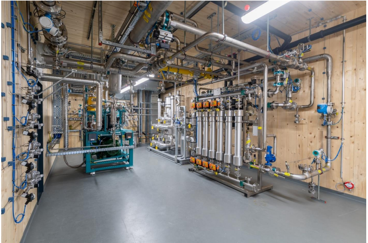
Abbildung 20: Klärgasverdichter, Aktivkohlekolonnen und Wasserstoff-Membrane [Limeco]
