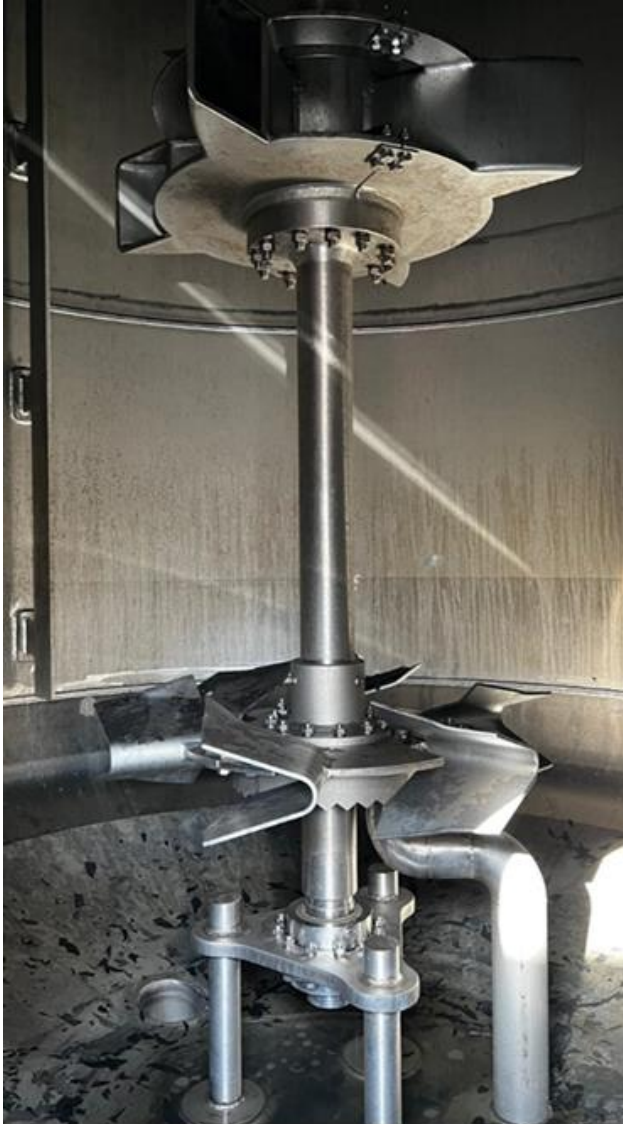
Abbildung 15: Rührwerk der Firma Ekato [Limeco]
