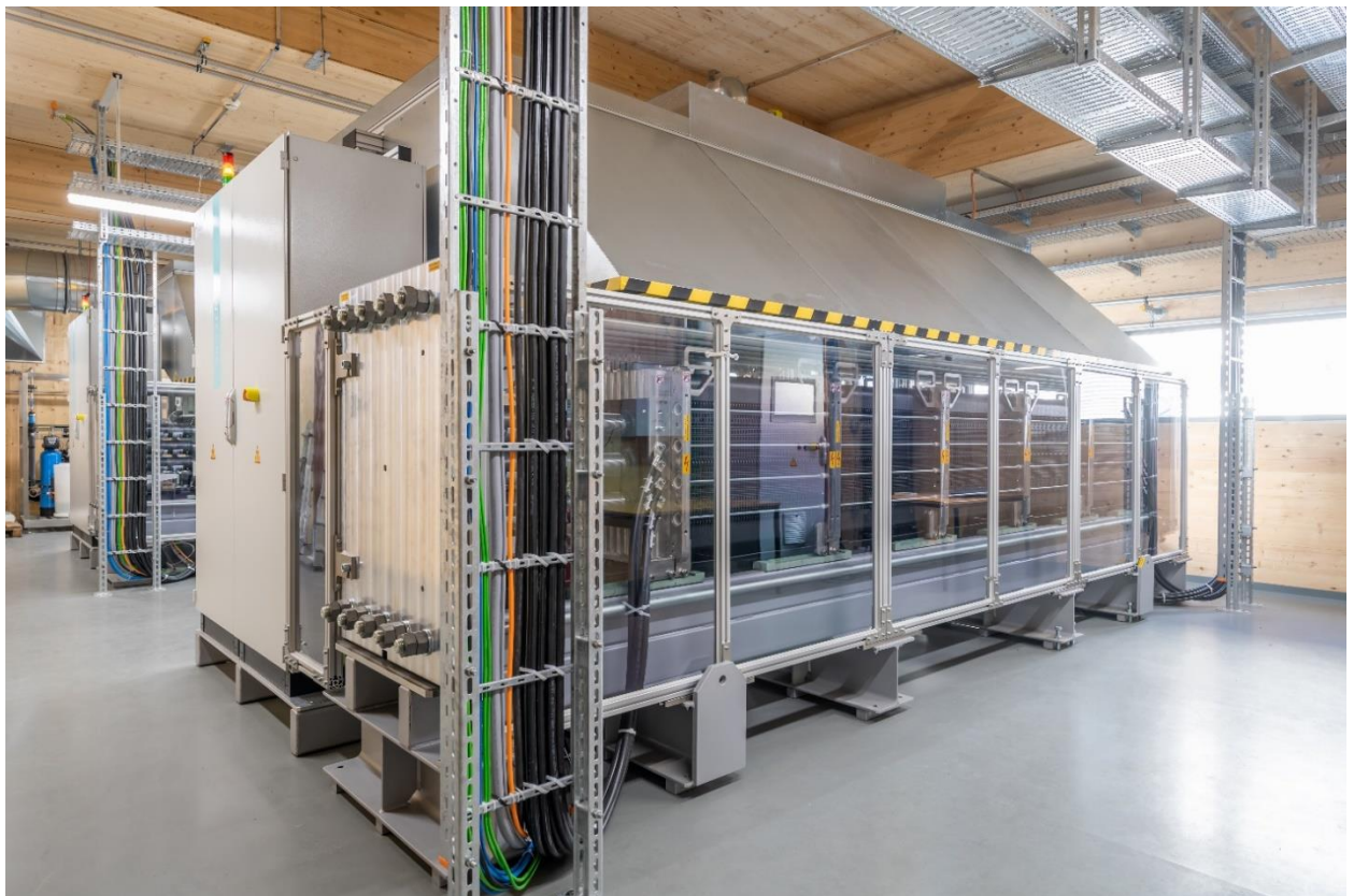
Abbildung 13: Zwei 1.25MW-Elektrolysesysteme [Limeco]
