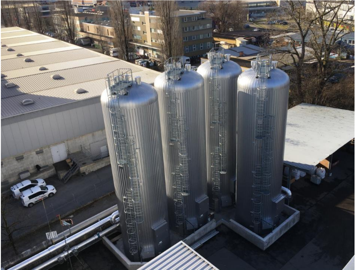
Abbildung 9: 2022 realisierte thermische Speicher Limeco [Limeco].
