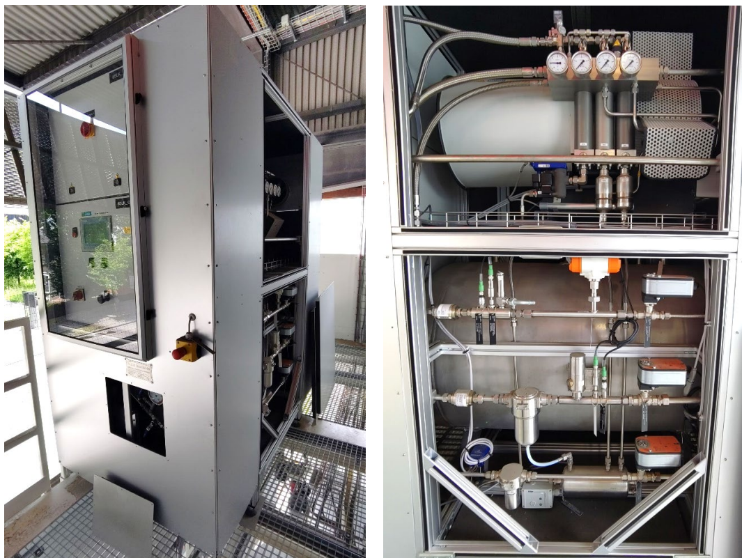
Abbildung 4: CO 2 -Kompressoreinheit mit Kolbenverdichter (rechts oben) und Druckspeicher (rechts unten)
