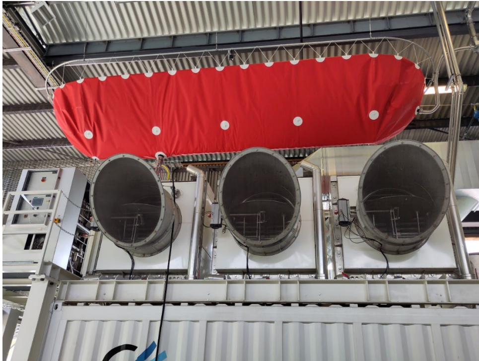
Abbildung 3: DAC-Anlage mit drei Adsorbereinheiten (Ansaugstutzen mit geöffneten Klappen sichtbar), Pufferspeicher (roter Ballon) und CO 2 -Kompressoreinheit (links)
