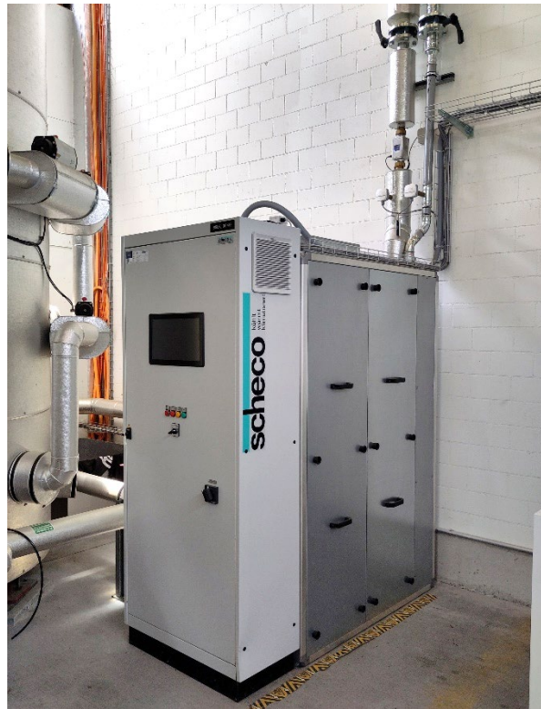
Abbildung 7: Hochtemperatur-Wärmepumpe und Climeworks Schichtspeicher (im Hintergrund links)
