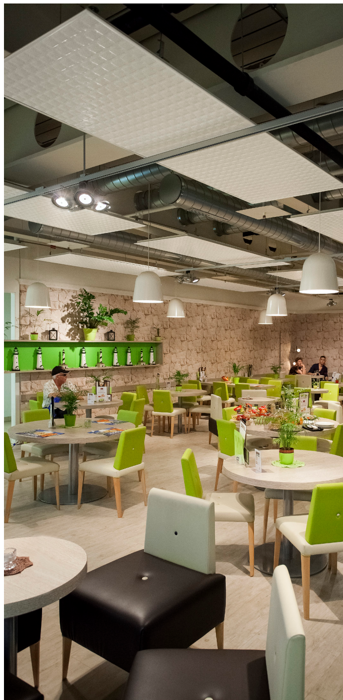
Deckenheizungen sind eine Spielart von Heizsystemen, die sich mit niedrigen Vorlauftemperaturen betreiben lassen. Foto: SOLTOP Energie AG
