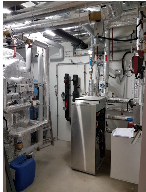
Abbildung 62: Technikraum Haus A der P&D Anlage, links der kubische Speicher, Mitte Niederhub WP, rechts isolierter Wärmetauscher der Solaranlage
