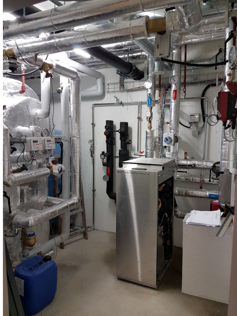
Abbildung 21: Technikraum mit Niederhub-Wärmepumpe.
