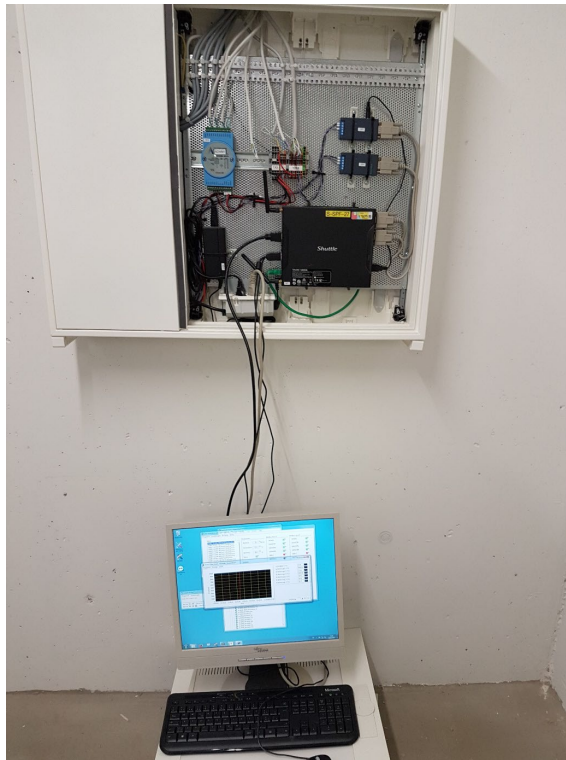
Abbildung 61: Elektroschrank mit Messrechner, installiert im Unterverteilerraum Haus A
