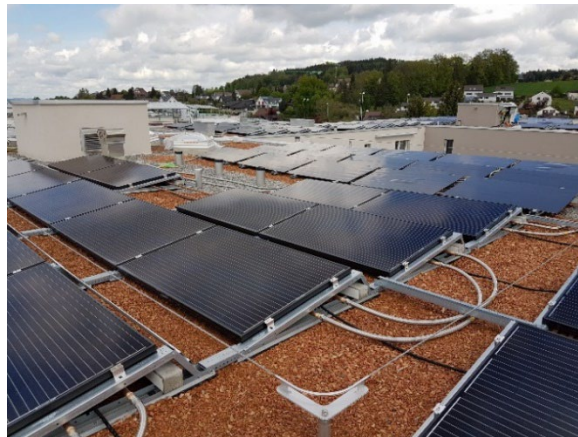
Abbildung 12: Vorne PVT-Kollektoren auf dem Dach von Haus B, die drei hintersten Reihen sind unabgedeckte, spektral selektive thermische Kollektoren der P&D-Anlage.
