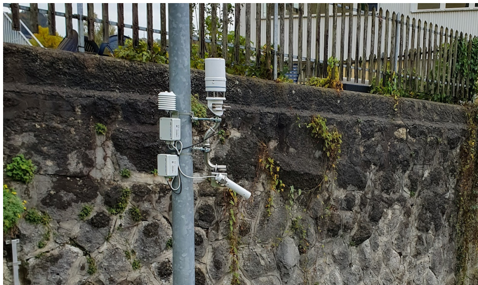
Abbildung 61: Infrarotsensor zur Bestimmung der Oberflächentemperatur des Asphalt und Wetterstation
