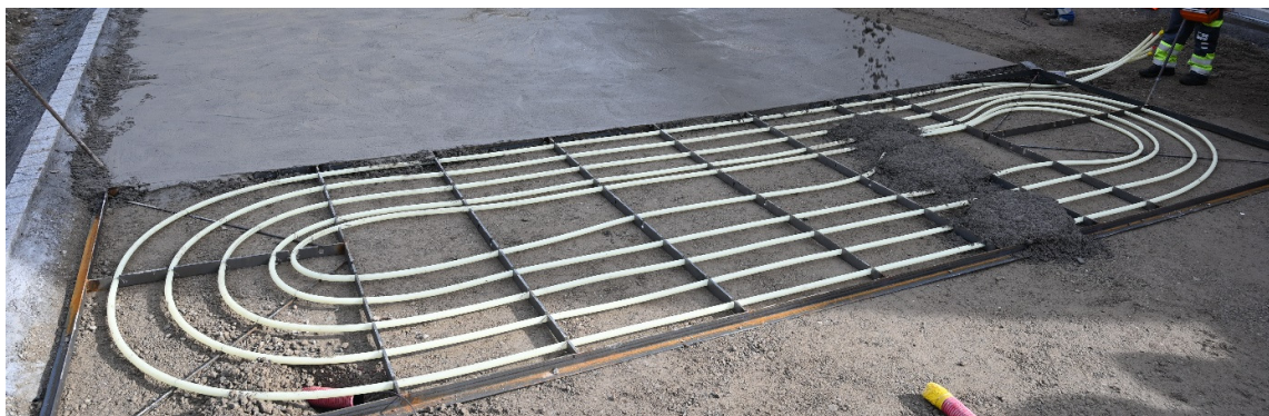
Abbildung 5: Asphaltkollektor-Einbau. Das Rohr wurde in einen Stahlrahmen eingelegt und in Zementmörtel eingegossen, im Anschluss erfolgte die Verbindung zu den restlichen Kollektoren
