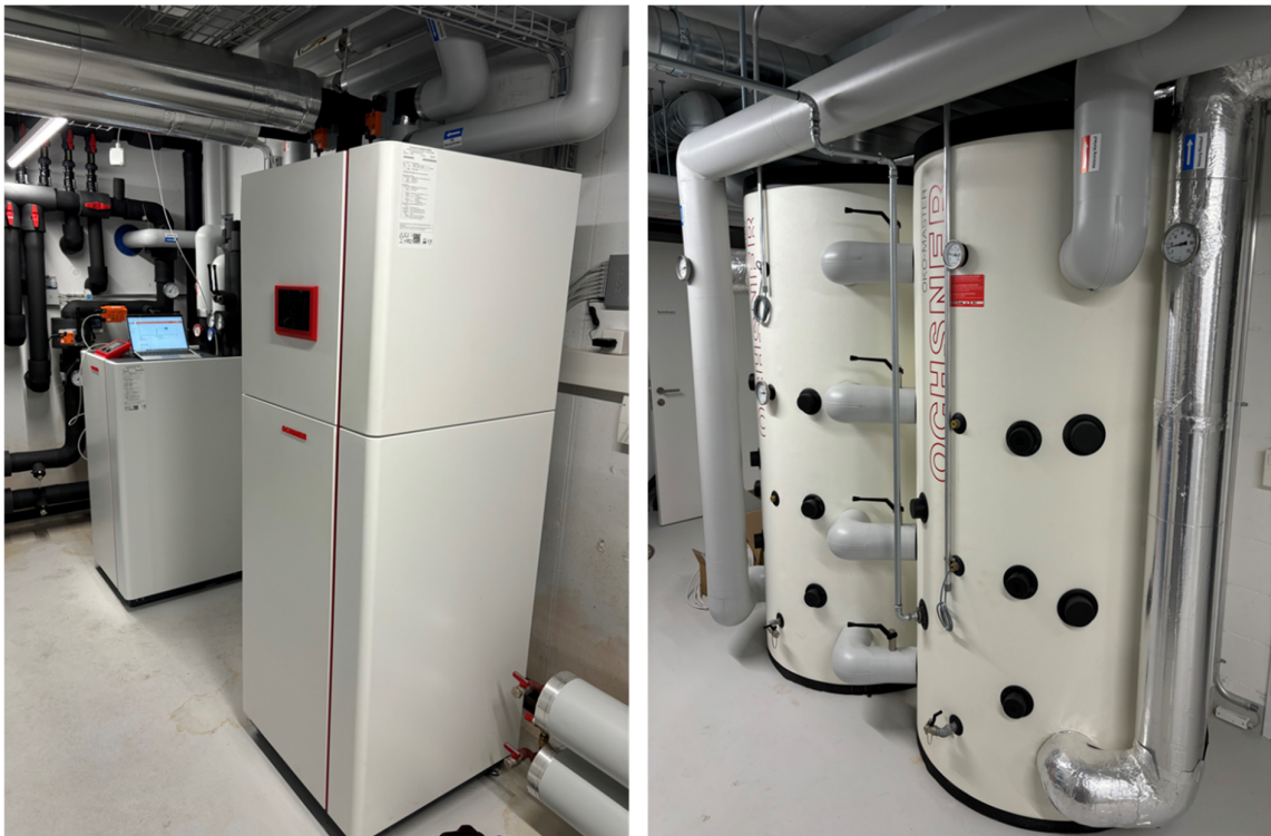
Abbildung 1: Links: Zwei Ochsner Wärmepumpen sorgen für genügend Heiz- und Kühlleistung. Rechts: Wärme- und Kältepufferspeicher mit je 1000 l Fassungsvermögen
