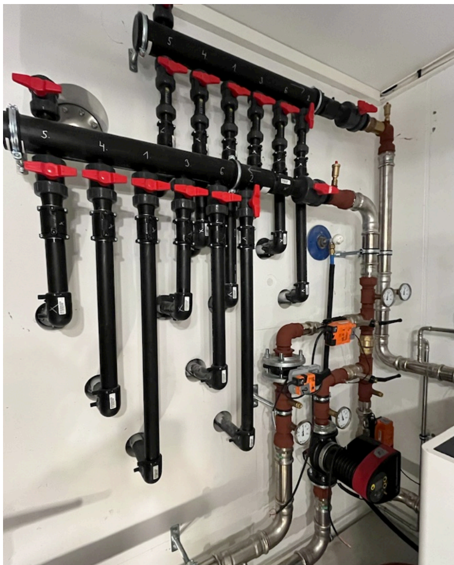
Bild 6: Vor- und Rücklauf der 6 Erdsonden (noch ohne Wärmedämmung). Am Rücklauf angeschlossen sind die Abgänge zu den Kollektorfeldern. Zwischen den Abgängen ist das Rückschlagventil sichtbar, im Kollektorkreis im Vorlauf der Wärmezähler (WZ-Koll), das Durchgangsventil und die Umwälzpumpe.
