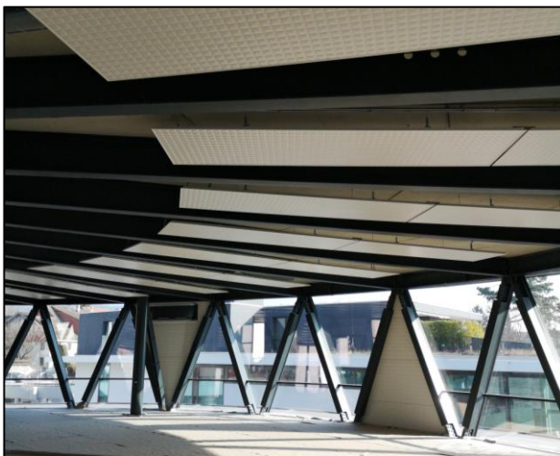
Abbildung 1-10: Deckenstrahlplatten im 1. OG
