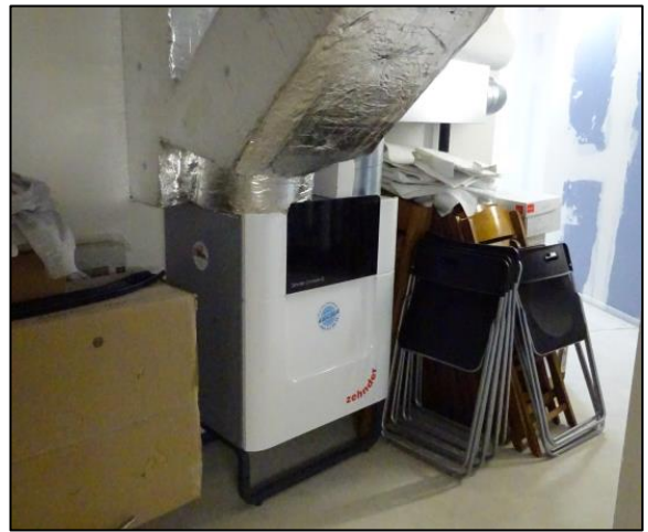
Abbildung 1-13: Lüftungsgerät für Bürobereich
