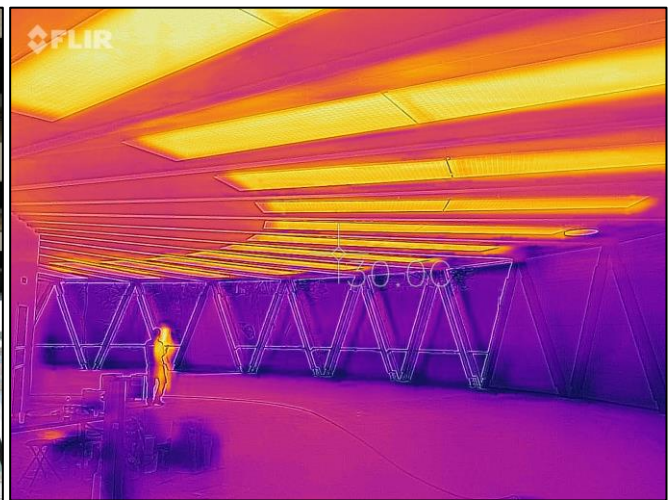
Abbildung 1-11: Deckenstrahlplatten im Heizbetrieb
