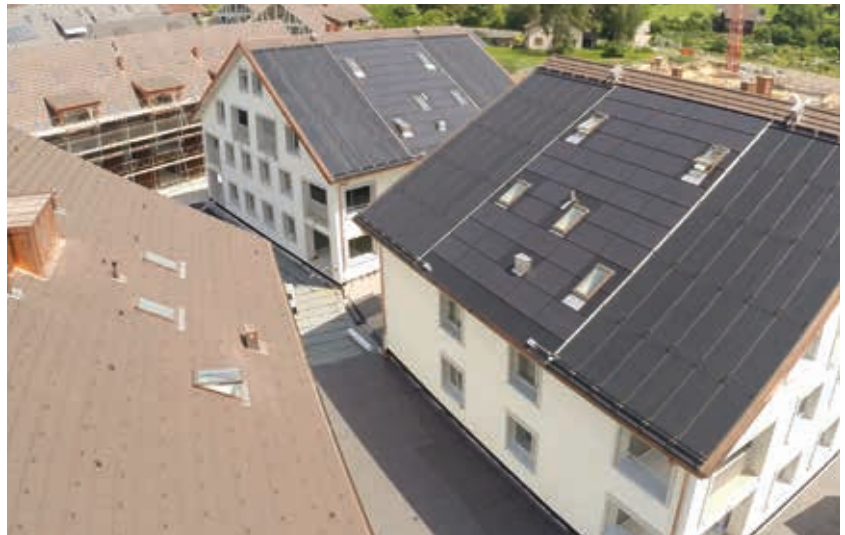
Projekt mit saisonaler Speicherung von Solarenergie in einem Erdwärmesonden-Feld (Bild: Huber Energietechnik).
