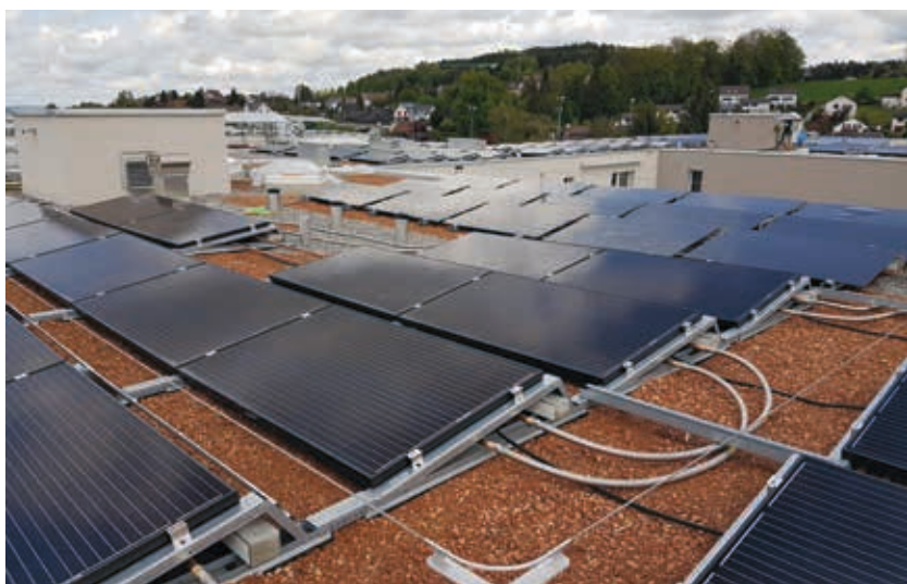
Hybridkollektoren für die kombinierte Wärme- und Stromgewinnung beim Neubauprojekt in Obfelden (Bild: SPF Rapperswil).
