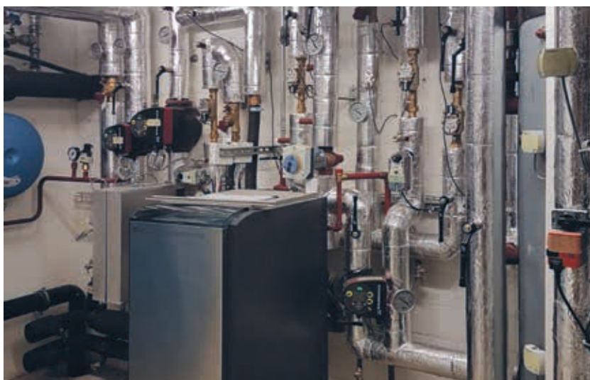
Steigerung der Energieeffizienz bei grossen Gebäuden und Betrieben durch Betriebsoptimierung – hier die Heizzentrale des Pilotprojekts in Obfelden (Bild: SPF Rapperswil).
